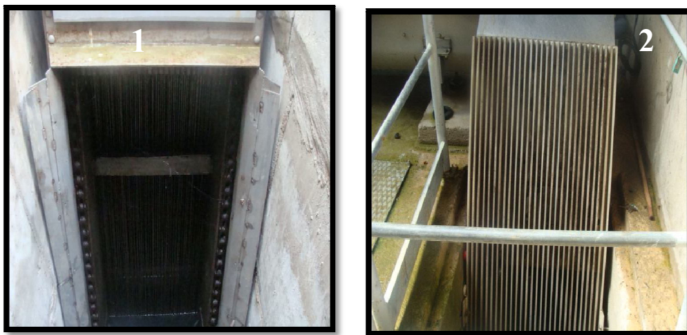
Figure II.3: Dégrilleur fin (1 : automatique, 2 : manuel)
