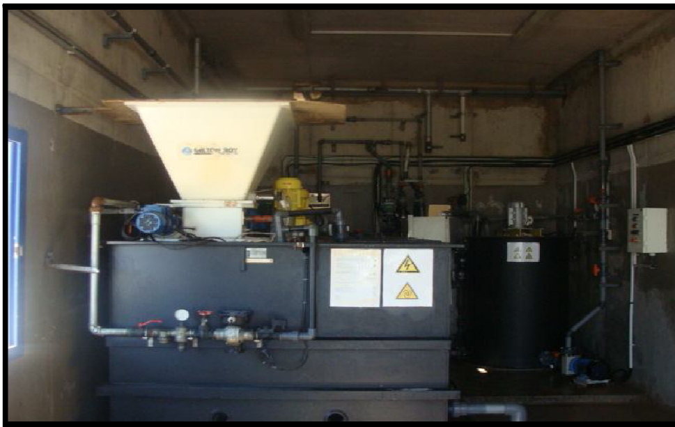
Figure II.13: Logement de Préparation du polymère
