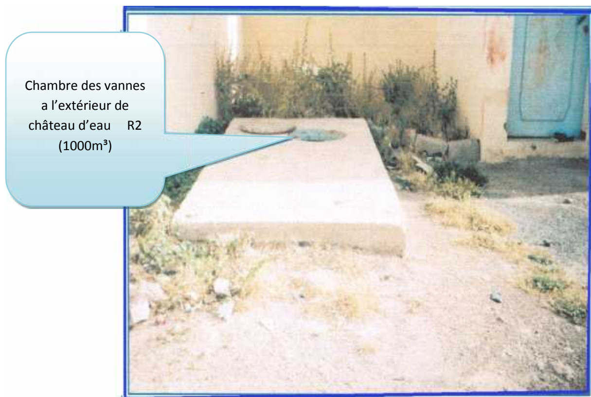
Figure II-5 : Chambre des vannes a l'extérieure de château d'eau R2 (1000m 3 ).
