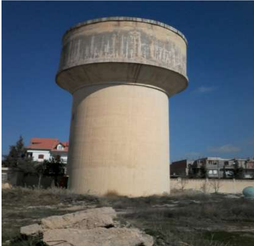
Figure V-1 : Réservoir surélève de 1000 m 3
