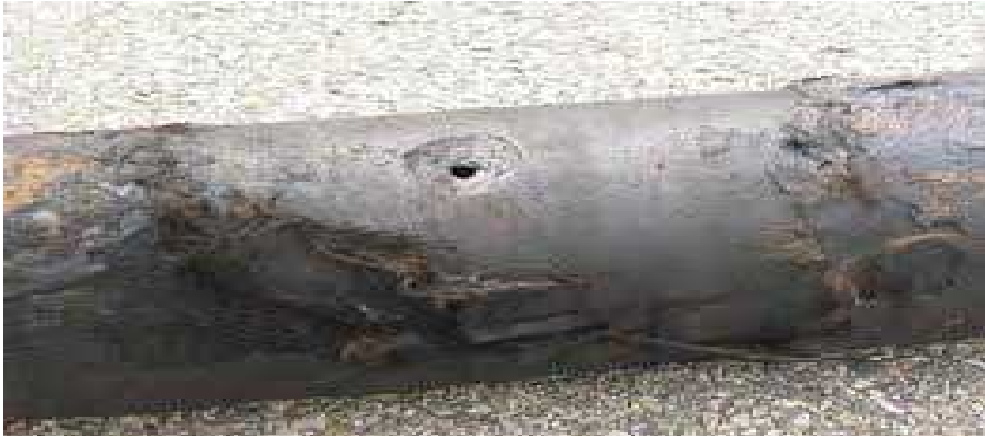
Figure II-9 : Photographie Corrosion externe. [11]
