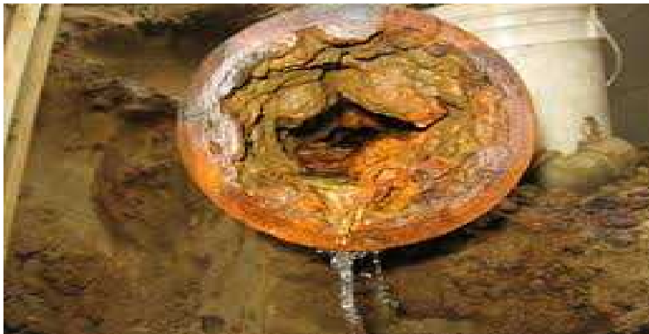
Figure II-8 : Photographie Corrosion interne. [2]
